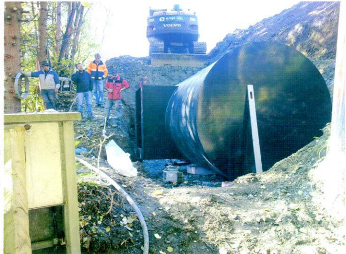
Pumpstation Wachtlehenweg - Wasserversorgung Lofererfeld (Bild: Stadtgemeinde Mittersill)
