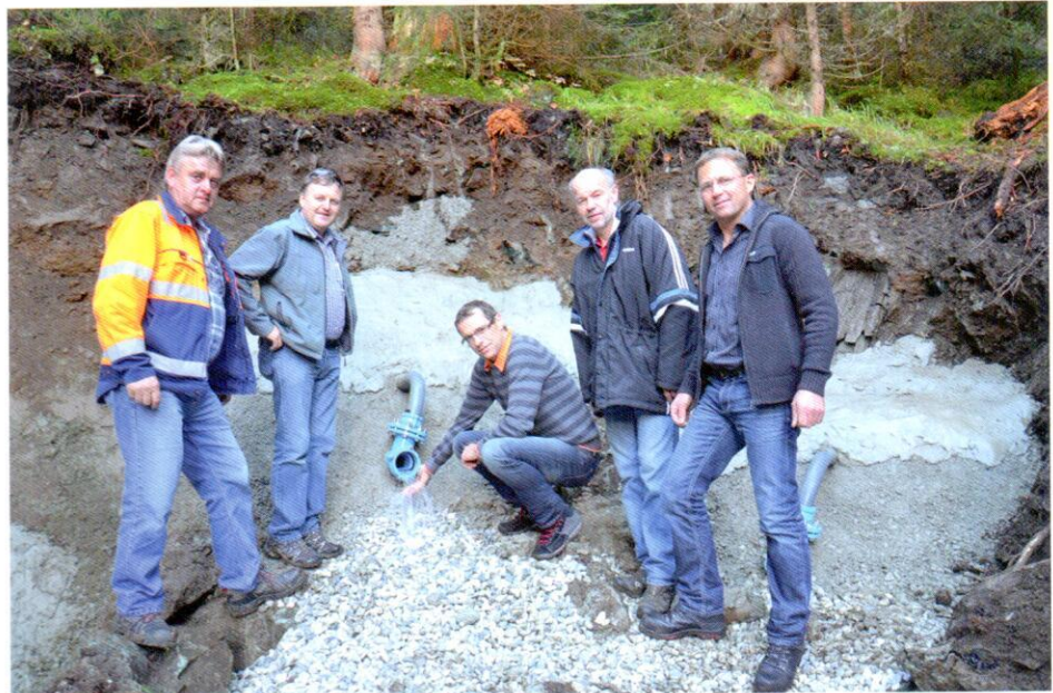
Franz Rieder und Mitglieder des Ausschusses für Bauangelegenheiten (v.r.: Andreas Lemberger, Martin Neumaier, Max Schwarzenbacher und Ausschussvorsitzender Franz Schratl) bei einer Besichtigung der Baustelle. (Bild: Stadtgemeinde Mittersill)
