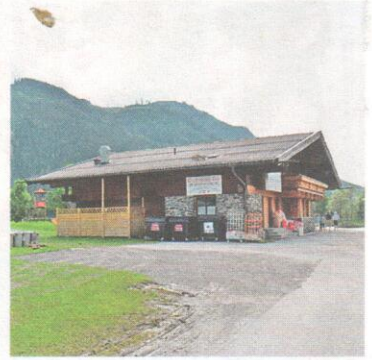
Freizeitanlage Hollersbach: Die Schäden sind groß. BILD: SIMO
