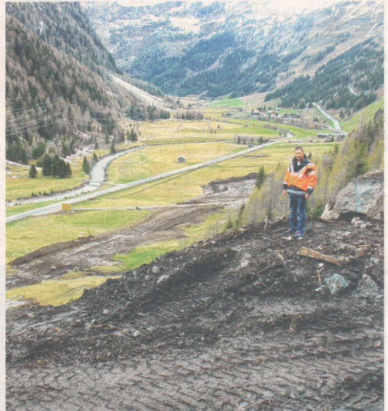
Klaus Kollnig, Betriebsleiter, an der zerstörten alten Trasse. Unten wird mit dem Bau der neuen begonnen. Im Hintergrund: die eher steile Ersatzstraße, die zum Südportal führt.
