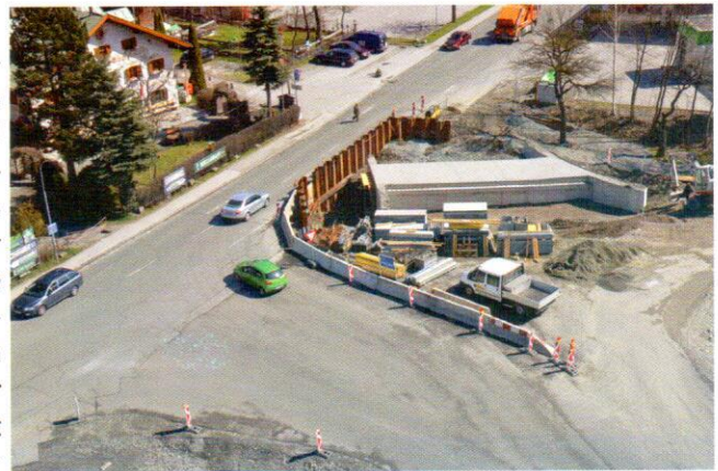
Deutlich zu erkennen ist bereits die zukünftige Fußgängerunterführung bei der Bundesstraße (Bild: Gemeinde Mittersill)
