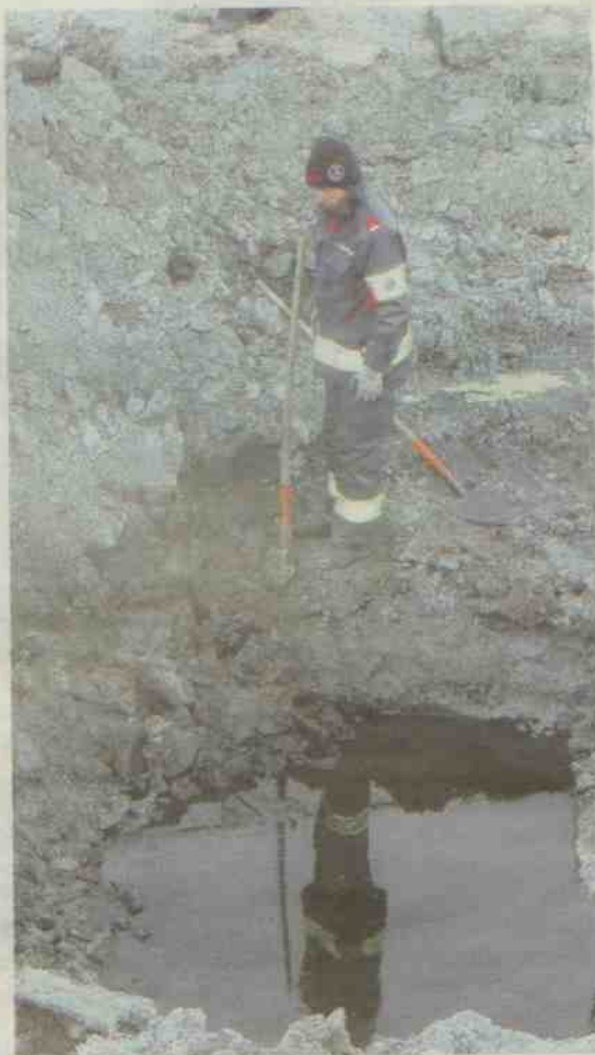
Ölsee nach dem Schaden bei der TAL in Mittersill vor genau einem Jahr. Bild: SN
