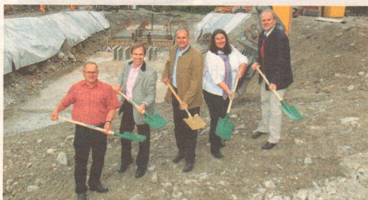
Spatenstich zum Hochwasserschutzprojekt in Flachau (v. l.) Hubert Kaml (Verbauungsgenossenschaft), Bgm. Thomas Oberreiter, LR Sepp Eisl, Dorith Breindl (Lebensministerium), Robert Loizl (Land Sbg.). Bild: SW/LPB
